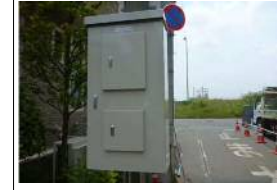
遠隔操作盤 (新設)
